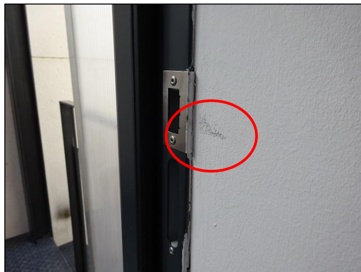
Resbalón que toca con la pared por no haber dejado marco.
