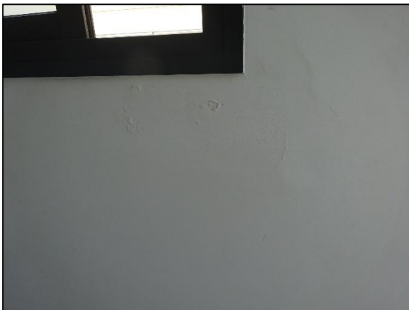
Afectación junto a ventana casetón escalera.
